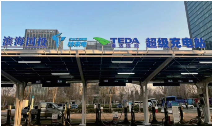
“光储充放检”一体化超级充电示范站
