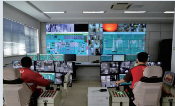
天津滨海合佳威立雅环境服务有限公司焚烧中控室
