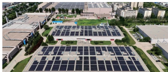
美克国际家私（天津）制造有限公司分布式光伏项目
